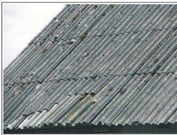
Fot.1 Pokrycie dachowe budynku gospodarczego z płyt falistych - I stopień pilności
