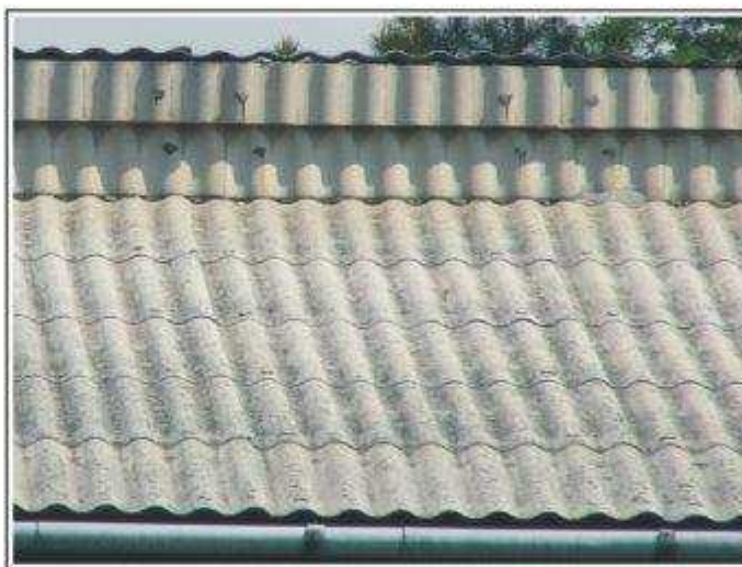
Fot.3 Pokrycie dachowe budynku mieszkalnego z płyt falistych - III stopień pilności
