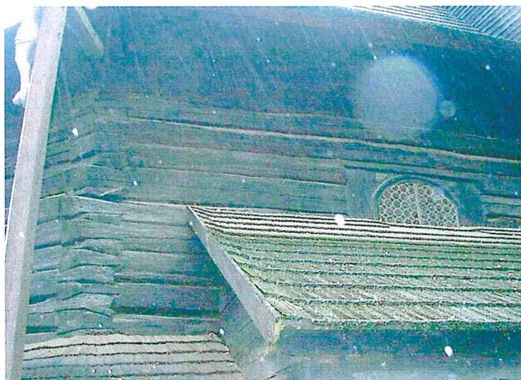
Fot.6. Ubytki belek w ścianie północnej prezbiterium, glony na gontach
