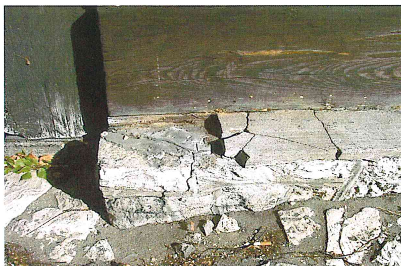
Fot.18. Odspojona nadlewka i pęknięta podmurówka od strony południowej
