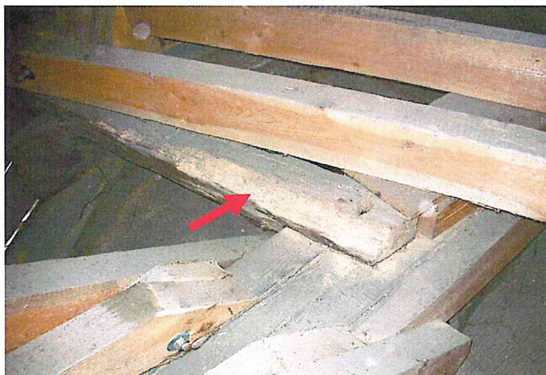
Fot.19. Zmurszała podkładka krokwi oraz nowe elementy – strona zachodnia
