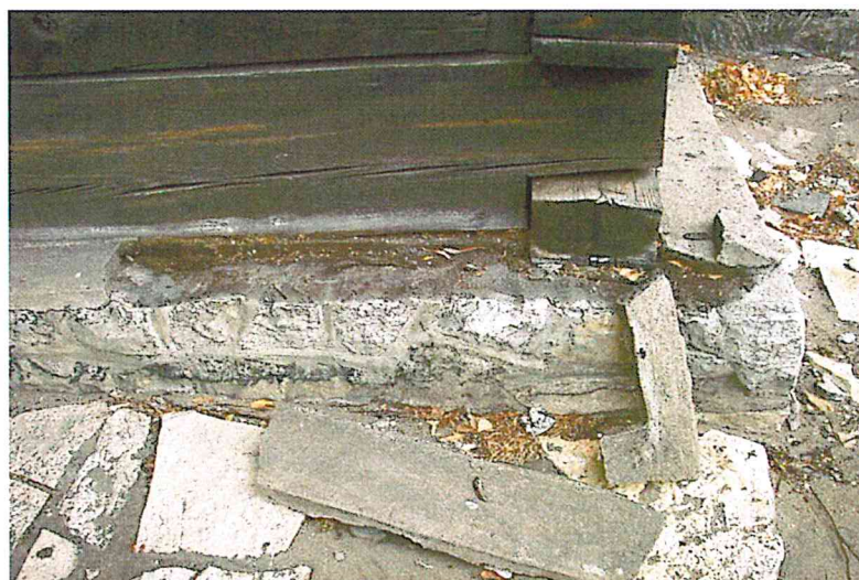
Fot.17. Odspojona nadlewka podmurówki ściany nawy od strony południowej
