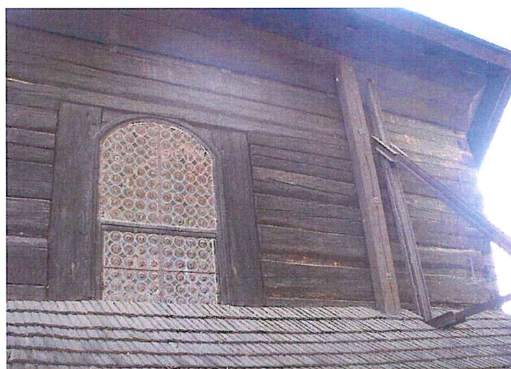
Fot.5. Wychylenie ściany i ślady korozji biologicznej od strony północnej
