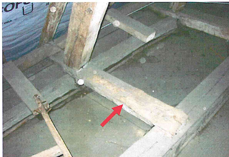
Fot.23. Zmurszała podkładka krokwi – strona wschodnia
