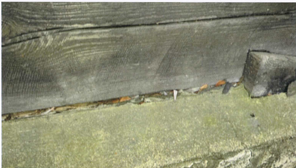
Podmurówka - widoczne fragmenty pionowej izolacji z papy
