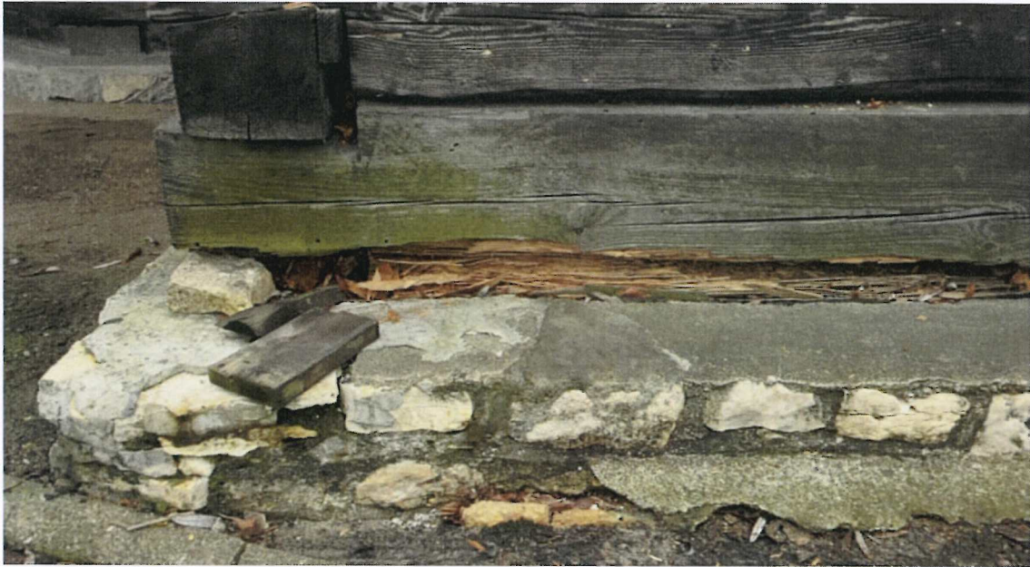
Zniszczona podmurówka z kamienia, skorodowana belka podwalinowa
