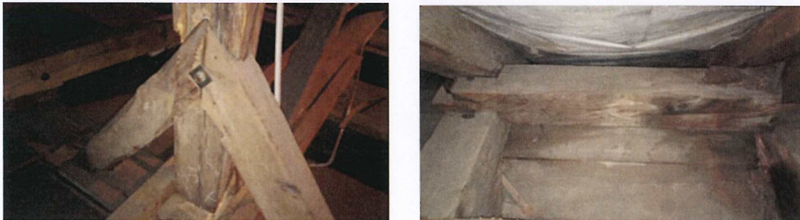
Zagryzione i zawilgocone elementy konstrukcji
