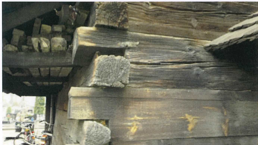
Zniszczenia spowodowane zmiennymi warunkami atmosferycznymi – naturalne spękania i wypaczenia starzeniowe
