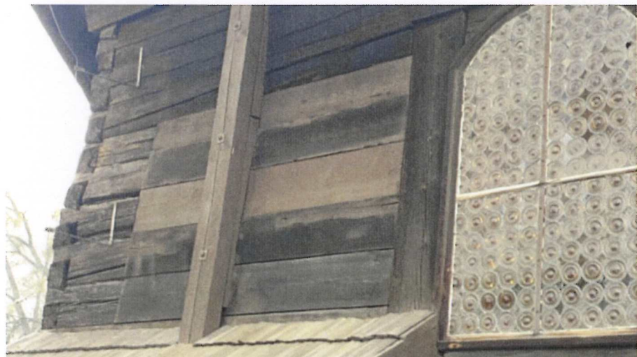
Wtórne wzmocnienia i naprawy balami - nie dopasowanymi wymiarowo i kolorystycznie – elementy nie przystosowane rysunkiem do starej konstrukcji
