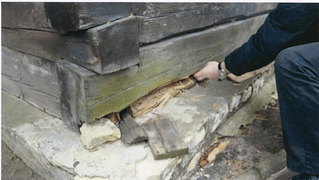
Stan techniczny podmurówki
