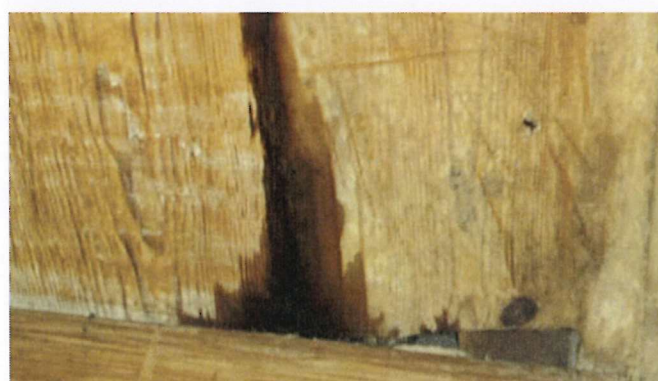
Destrukcyjja i zalanie element6w konstrukcji ch6ru
