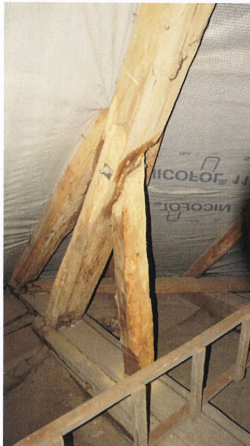
Widoczna korozja elementów więzby dachowej
