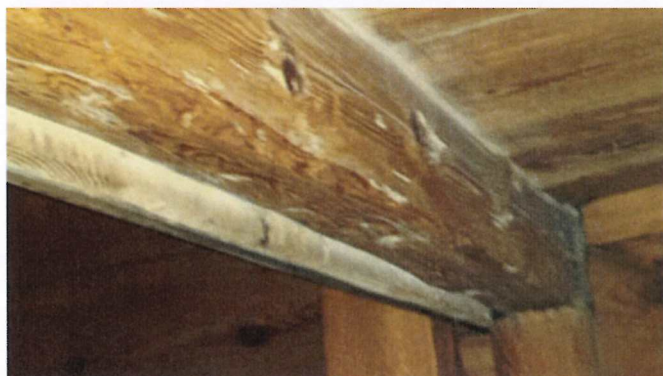
Elementy konstrukcji chóru zaatakowane przez techniczne szkodniki drewna – impregnowane i szpachlowane
